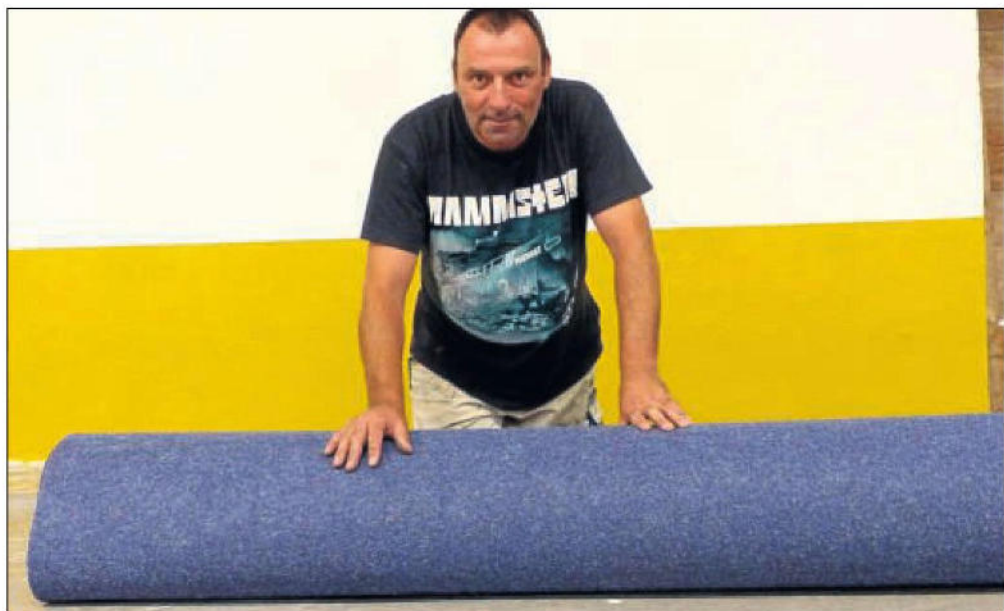
Gestern rollten Dirk Klawin und weitere Mitarbeiter der Firma Dreschel den widerstandsfähigen und sechs Millimeter dicken Nadelfilzboden aus.
